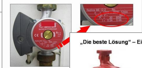
„gute Lösung“ – elektronisch geregelte Pumpe
